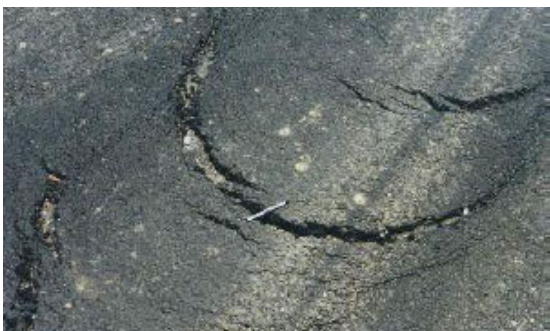
그림 8. 포장 내구성 결함에 의한 파손
