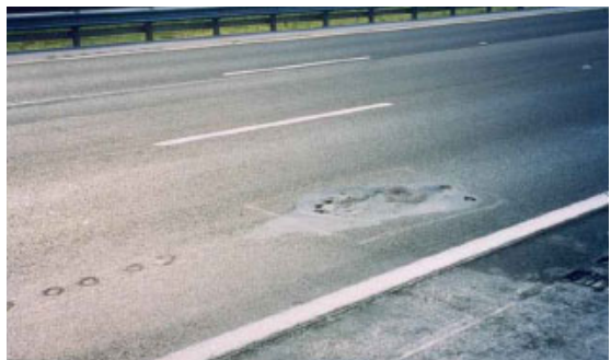
그림 9. 차량 연료에 의한 파손
