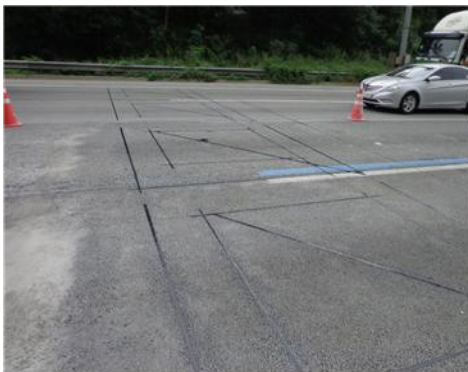
그림 5. 3-Sensor 설치 현장 Fig. 5. 3-Sensor setting places
