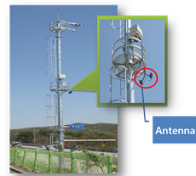
〈그림 5〉 도로변에 설치된 WAVE용 기지국 통신장치 〈Fig. 5〉 Roadside base station unit for WAVE communication
