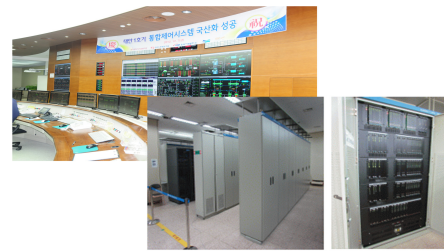
그림 3 통합감시제어시스템 현장설치 사진 (태안화력 1호기) Fig. 3 Installation of IMCS (Tae'an unit 1)
