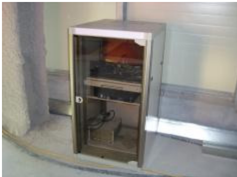
Fig. 12 Rack(데이터 로거, 서버) 설치 사진
