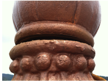
(e) 가로등 결합부 용접 균열
