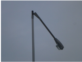
(a) 상부 연결부 탈락
