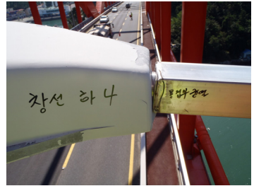
(c) 등기구 결합부 균열
