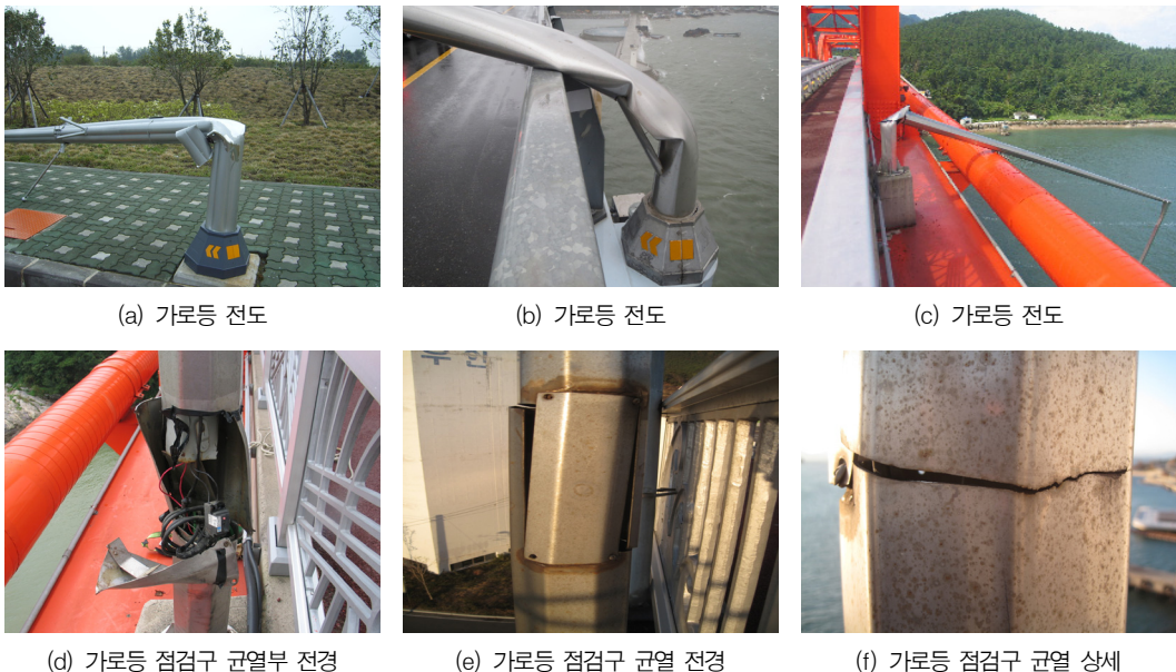
Fig. 1 가로등 점검구의 주요 손상 사례
