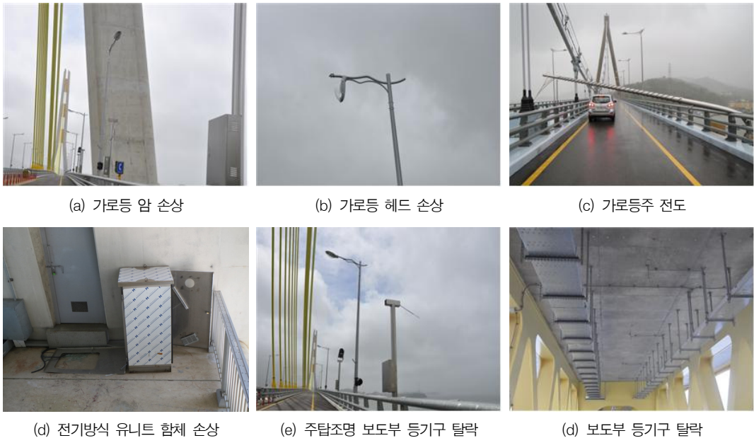
Fig. 1 태풍피해에 따른 전기시설물 손상현황
