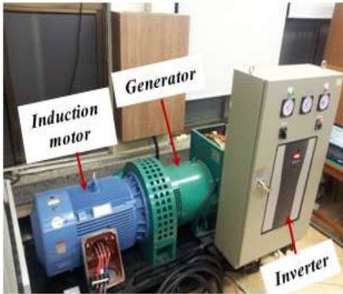
그림 13. 동기발전 시스템 사진 Fig. 13. photograph of synchronous generator system
