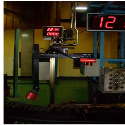
그림 12. 설치된 측정 모듈. Fig. 12. Installed measurement modules.
