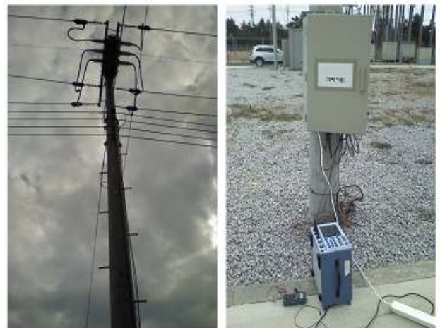
그림 3. 개폐기 계측 전압 오차 측정 Fig. 3. Error measurement of switchgear's measuring voltage
