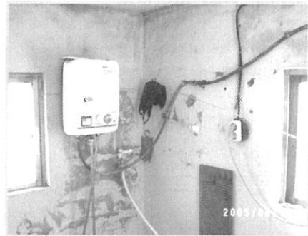
[세면장에 설치된 온수기]
