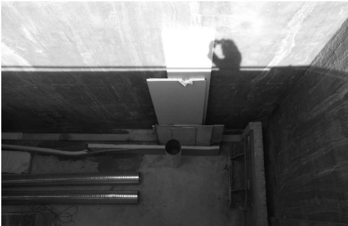
추락지점(지하층 콘크리트 바닥)
