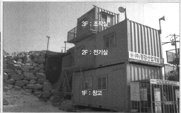
【사진 2】 골재생산 설비용 전기실 및 조작성실
