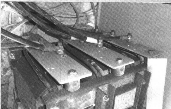
【사진 5】 신규 설치한 전동기 기동장치(리액터) 전원 접속부
