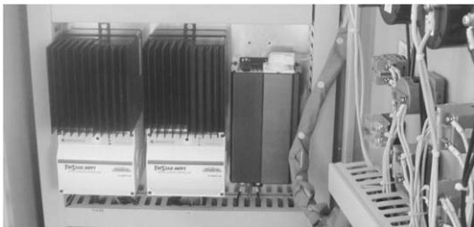
Fig. 17 설치된 솔라 컨트롤러 부
