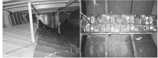
Fig. 18 설치된 태양광 배터리 뱅크
