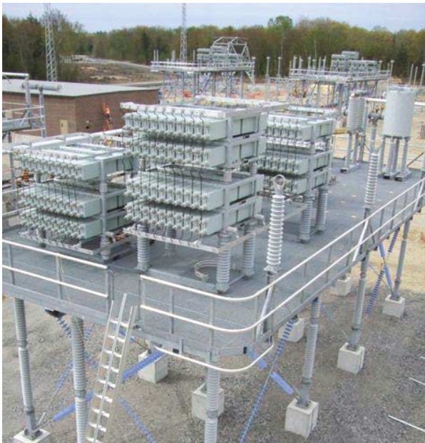
[그림 11] 직렬콘덴서 설치광경(비여자 상태)
