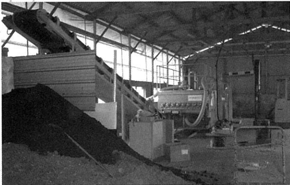
【그림 1】 재해 발생 설비(계분 건조설비)
