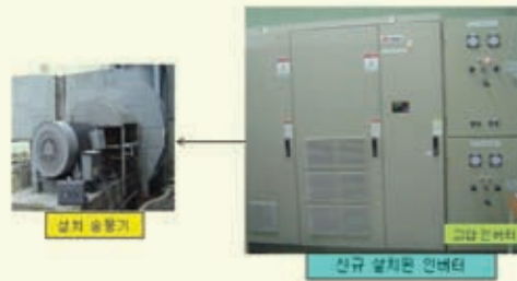
〈그림 14〉 송풍기 및 설치된 고압인버터
