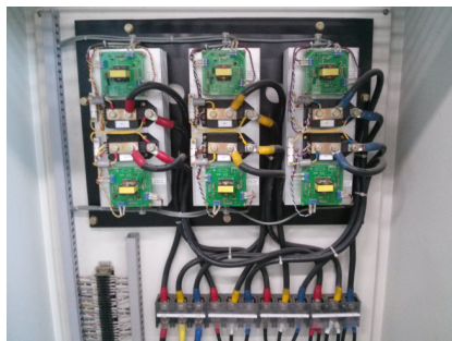
그림 3 사고발생장치 Fig. 3 Fault Generator
