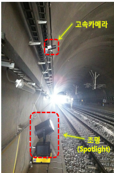
(b) 터널구간 비접촉 압상량 검측 장치 (b) Condition Monitoring System in Tunnel
