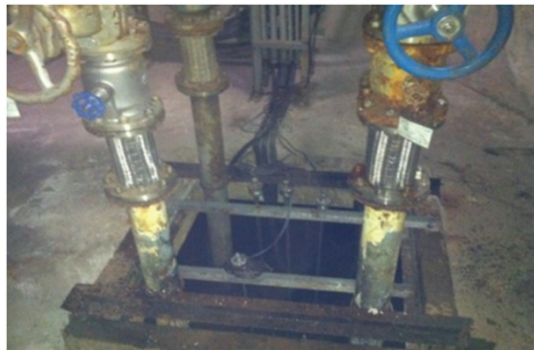
[그림 3] 통신구내의 집수정 및 배수시설
