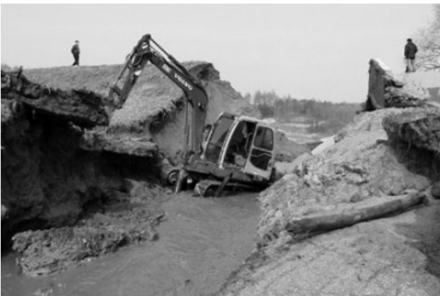
그림 8. 송호저수지 붕괴 상태
