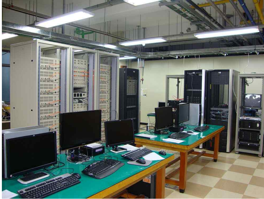
그림 2. VCS 본제품의 현장설치 후 시험 사진.
