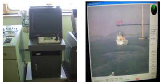
그림 8. 선박내부 중앙제어장치 탑재 Fig. 8. Set central controller up on bridge
