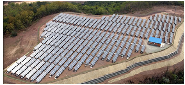
그림 3 서광 솔라 태양광 발전소 Fig. 3 Seokwang Solar photovoltaic power plant
