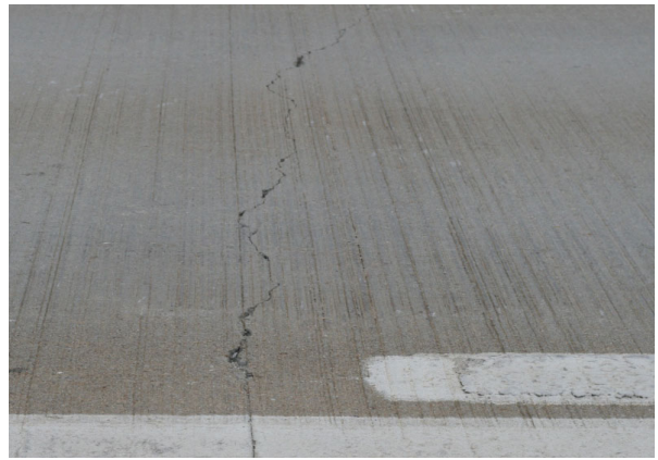
(b) 중부내륙 262.14km(충주-103)의 횡방향 균열
