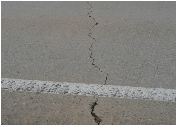
(a) 261.90km(충주-102)의 횡방향 균열
