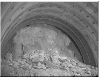
사진 3. 연질지반 붕괴 예
