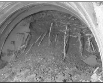
사진 2. 층상지반의 붕괴 예
