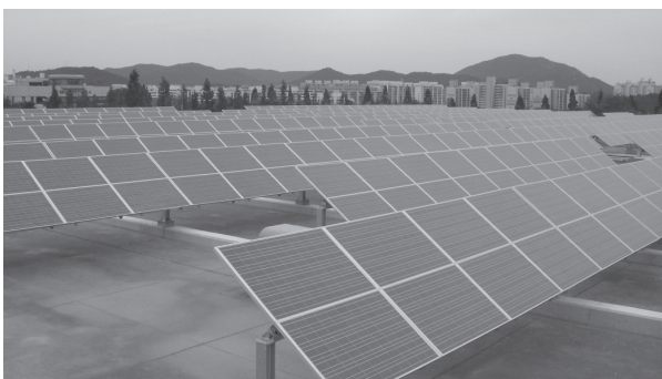
그림 7 태양광 발전소 설치 사례
