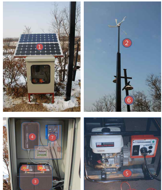
그림 5. 시험 제작한 인버터, 축전지 충방전, 발전기 자동구동 컨트롤러가 포함된 독립가옥의 태양광, 풍력, 소형발전기 복합발전시스템
