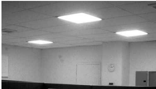
그림 8. 테스트베드 LED 설치현황 Fig. 8. LED Lights in Testbed
