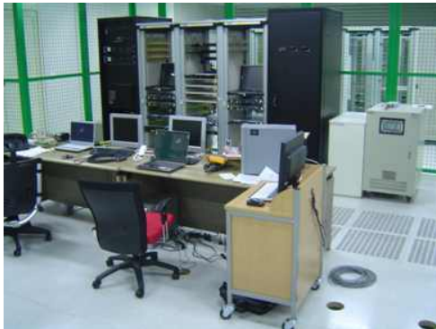
그림 2 IDC test bed의 외관 Fig. 2 Photo of IDC test bed
