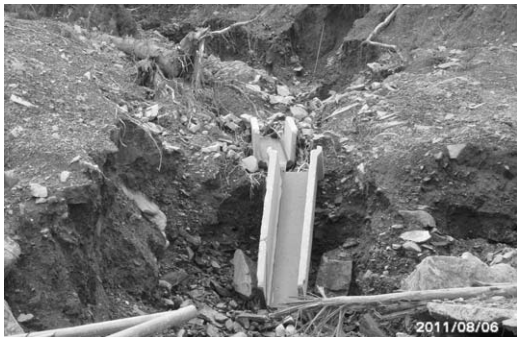
〈비탈면 배수로 파손 전경〉
