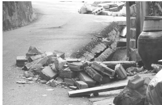
옹벽 및 노면 밀림 발생
