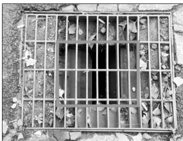
토사 막힘에 의한 우수받이
