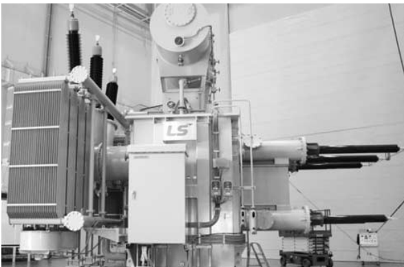
[그림 4] HVDC Converter Transformer
