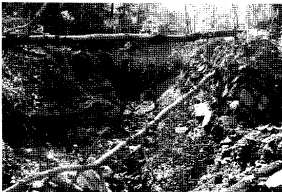
[그림 4] 토류석량증가로 세굴 범위 확대(깊이 약 3m)
