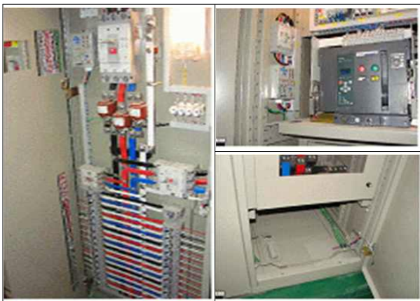
그림 3. SPD 시공 실태 Fig. 3. Pictures of SPD installed in Apartments
