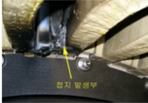
그림 1 발전기 고정자 권선 손상 Fig. 1 generator stator winding damage
