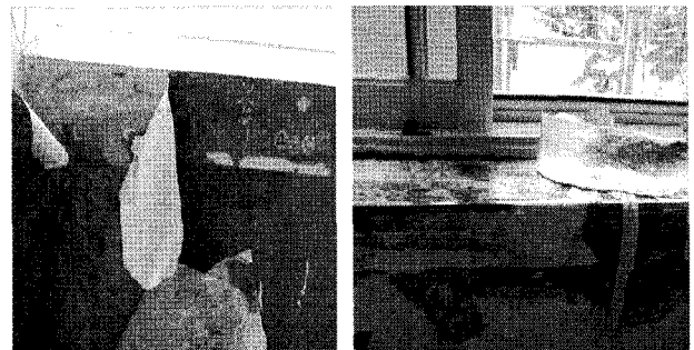
<그림 1> 건축물 내부 결로로 인한 오염원 발생현황
