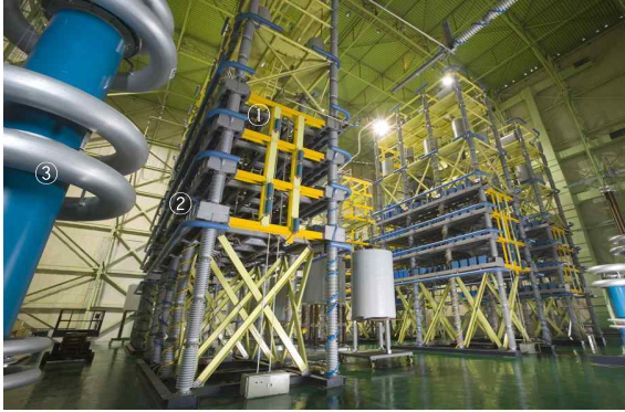
그림 6. 합성 차단 성능평가 시험설비 Fig. 6. Testing facilities for synthetic breaking test
