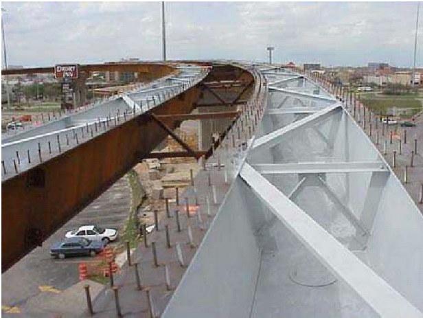
그림 1. 바닥판 타설전 상부 수평브레이싱 및 내부 수직브레이싱으로 보강된 U형 강거더 (Bradberry 등, 2005)
