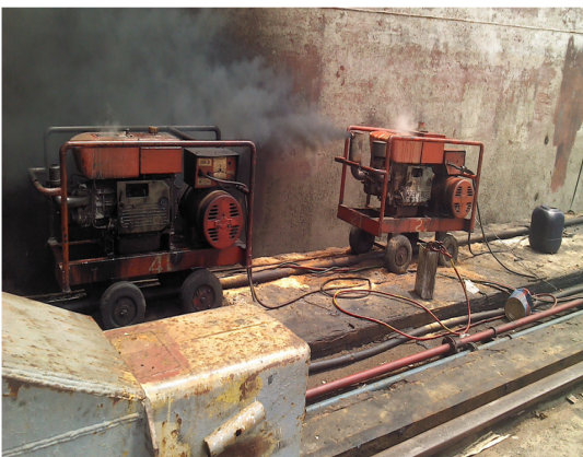
그림 2. 발전기 운영 상태 Fig. 2 Generator operating conditions
