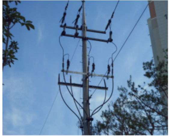
그림 1. 2회선 케이블 전주 Fig. 1 The electric pole of two line cable
