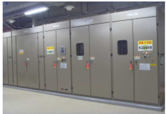
그림 4.. 양산평산아파트전기공사1공구 수변전설비 Fig. 4 Electrical room with hydro power generation of Yangsanpyeongsan apartment
