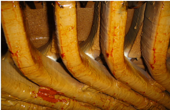
그림 1 단말권선 교차부위 백화현상 Fig. 1 White powder on end-winding intersection
