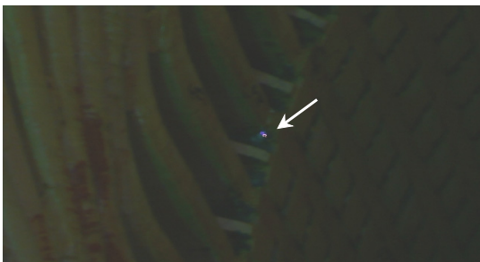
그림 8 고전압 시험 중 방전불꽃 Fig. 8 discharge spark on high voltage test
