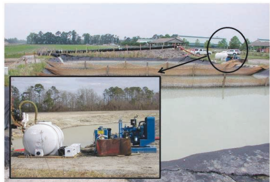
그림 6. 침사지 (settling basin) 탁수 처리에 사용되는 응집제 주입 장치
