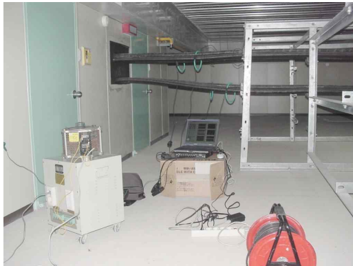
그림 6. 배전 중성선 분류 전류측정 Fig. 6. Measurement of split current of distribution line neutral
