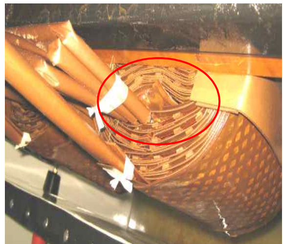
그림 5. 단락시험시 내측권선이 철심 방향으로 찌그러짐이 발생한 22.9[kV] 지상설치형 변압기 내부 Fig. 5. Inside view of the inside winding bent towards Core of 22.9[kV] pad mount transformer by short-circuit test
