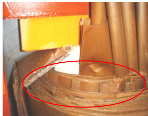
그림 3. 단락시험 시 저압 권선이 이탈된 22.9[kV] 지상설치형 변압기 내부
