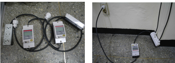
그림 3. 전력량 측정 모습 Fig. 3. Appearance of Measuring Electricity Energy
