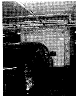
b) 지하주차장 팬룸 모습
