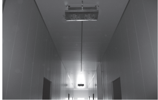
[그림 3] 전실 유닛콜러 설치
