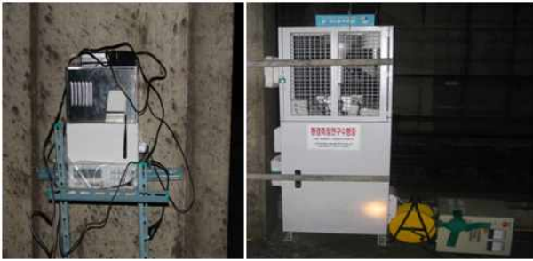
그림 11. 터널에 설치된 공기질 측정 장치 Fig. 11. Air quality measurement apparatus set up in tunnel.
