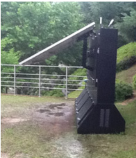
〈그림 3〉 태양광 판넬의 설치 사진 〈Fig. 3〉 An installed solar panel picture
